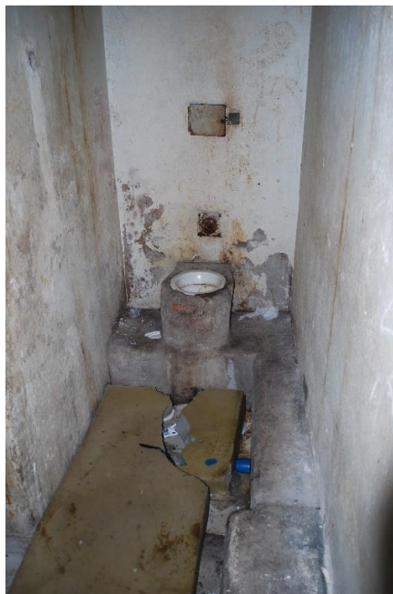
Foto 30: Condições estruturais da penitenciária de São Joaquim de Bicas I. Fonte: MNPCT.
