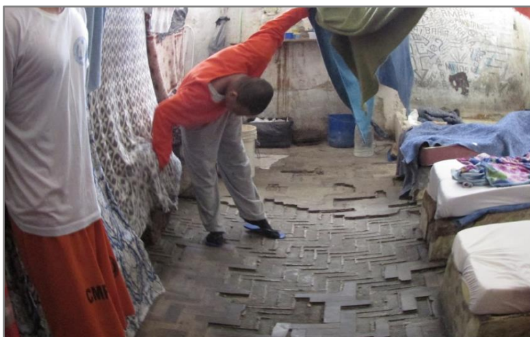
Foto 42: A estrutura do estabelecimento de saúde penal era precária e subumana. Fonte: MNPCT.
