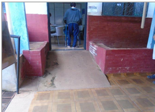
Foto 22: Falta de acessibilidade adequada, rampa sem corrimão. Fonte: MNPCT.
