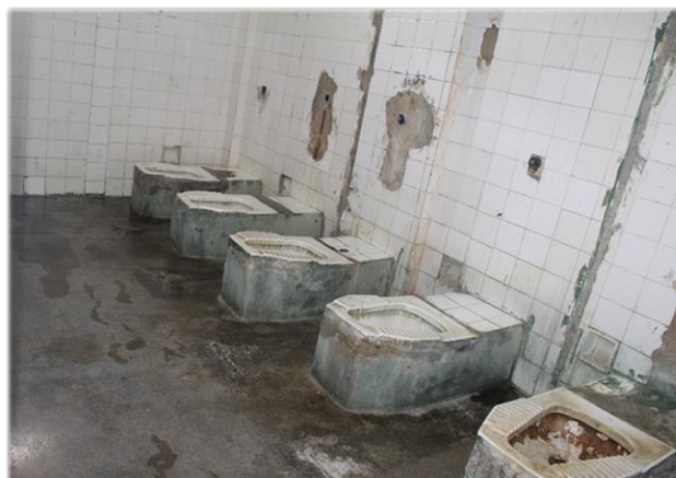
Foto 18: Banheiro CASE Salvador. Fonte: MNPCT.
