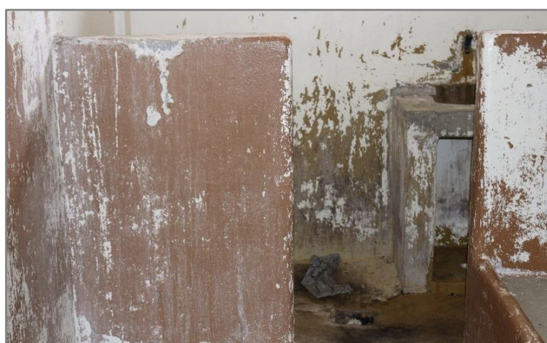
Foto 38: Alojamento de isolamento individual da Unidade feminina em péssimas condições de conservação. Fonte: MNPCT.
